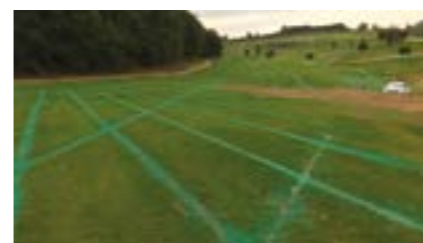
Qui sopra, dettagli dei nuovi e importanti interventi di drenaggio di ACQUAFERT Green sul percorso dell'Antognolla
